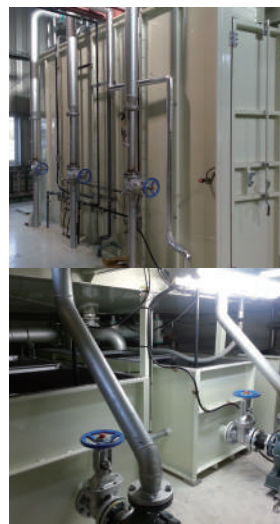
【図2】前処理設備
