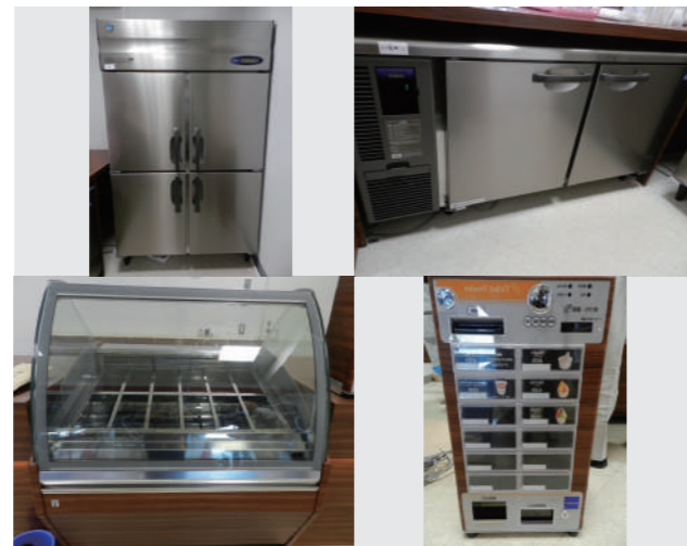
【図1】冷凍庫の設置状態(左上) / テーブル型冷蔵庫の設置状態(右上) / ジェラートショーケースの設置状態(左下) / 券売機の設置状態(右下)
